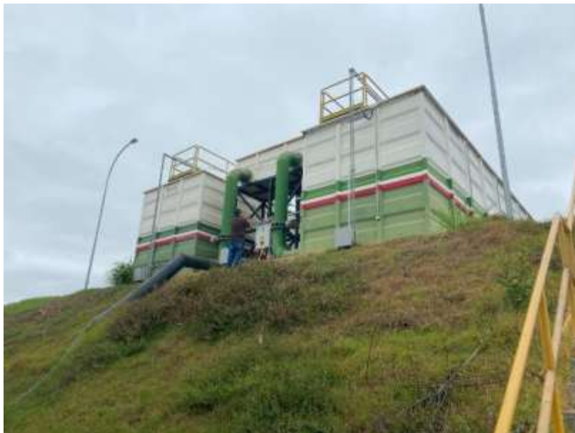
Figura 149: ETA Barra do Pari – Entradas de Água Bruta
