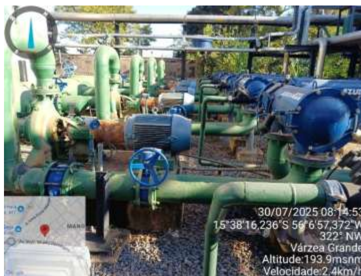
Figura 126: Conjuntos de Motobombas e Filtros de Tela para a Alimentação dos Módulos de Ultrafiltração
