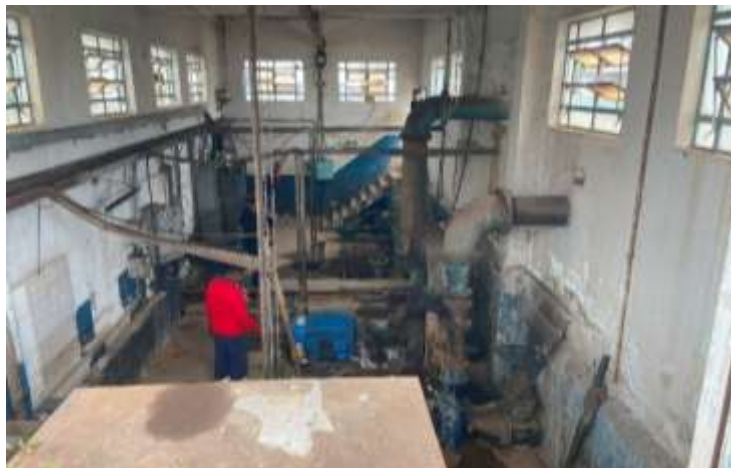
Figura 89: EEAT – Lavagem de Filtros no CR do Morro do Urubu
