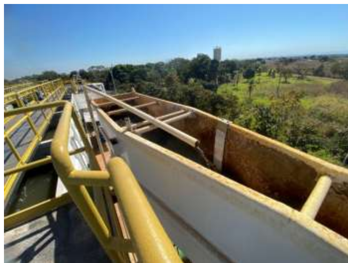
Figura 167: Calha Parshall e Dosagem de Produtos Químicos
