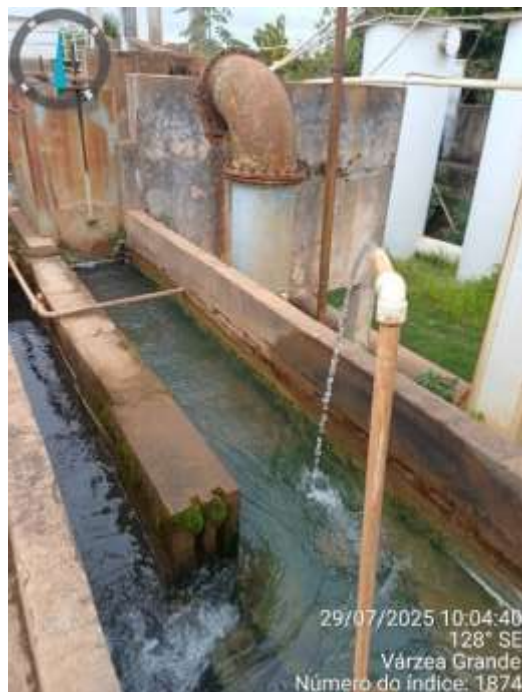
Figura 69: ETA 1 – Entrada de Água Bruta
