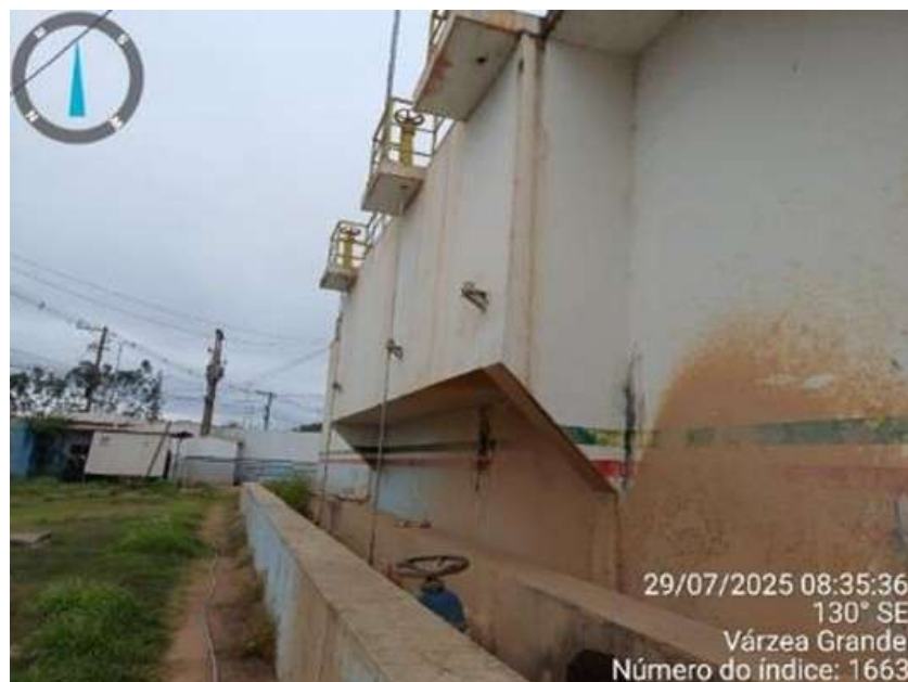
Figura 114: ETA 1 – Caixa de Descarga – Vista Parcial
