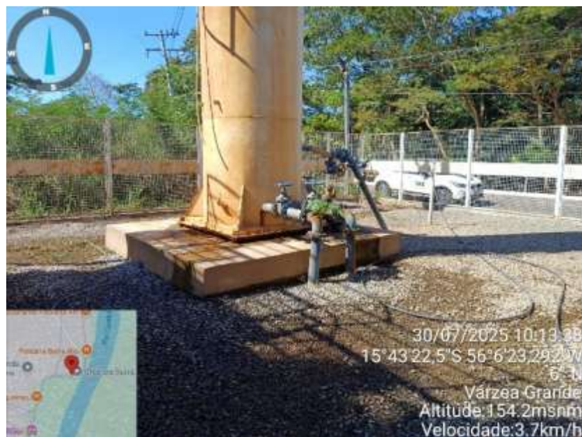
Figura 164: Reservatório Tipo Torre – Tubos de Saída
