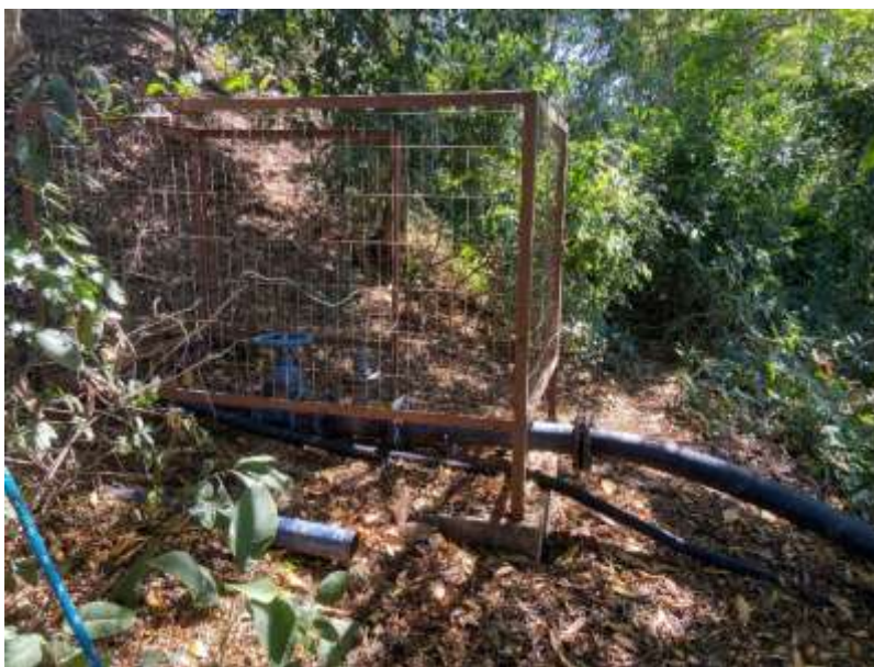
Figura 57: Equipamentos de Proteção da Estação Elevatória de Água Bruta
