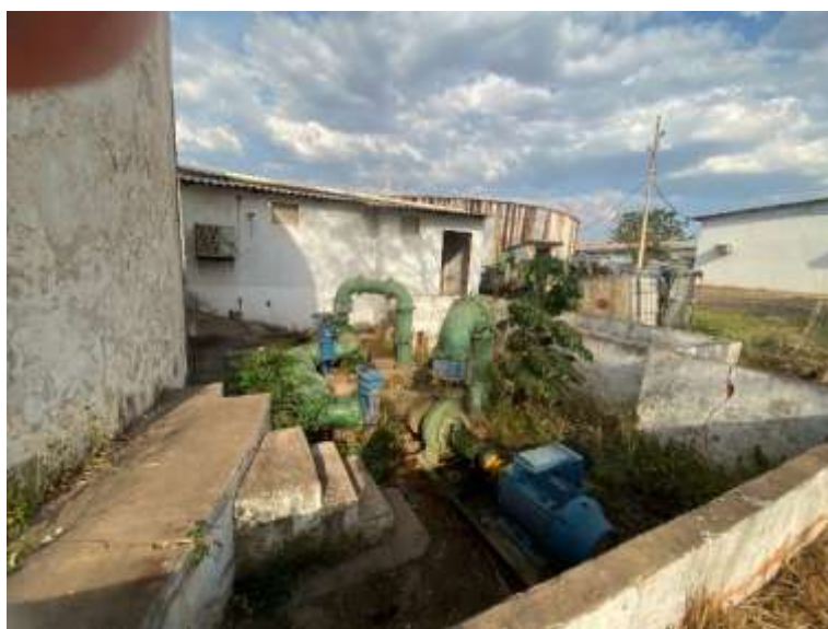
Figura 123: EEAT 06 – Vista Parcial que Segue para a Rede de Distribuição
