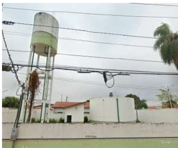
Figura 195: Centro de Reservação Cohab Cristo Rei
