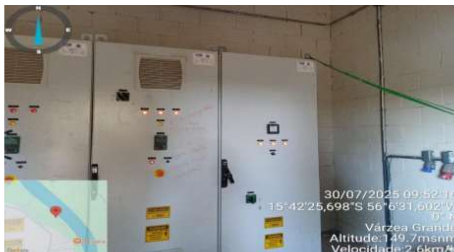
Figura 61: Sala de Comando dos Equipamentos de Recalque
