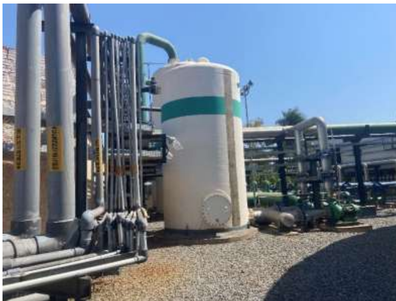
Figura 127: Tanque e Motobombas de Retrolavagem
