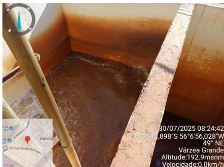
Figura 137: Tanque de Neutralização da Lavagem dos Módulos de Ultrafiltração
