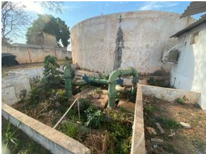
Figura 120: EEAT 06 – Segue para a Rede de Distribuição
