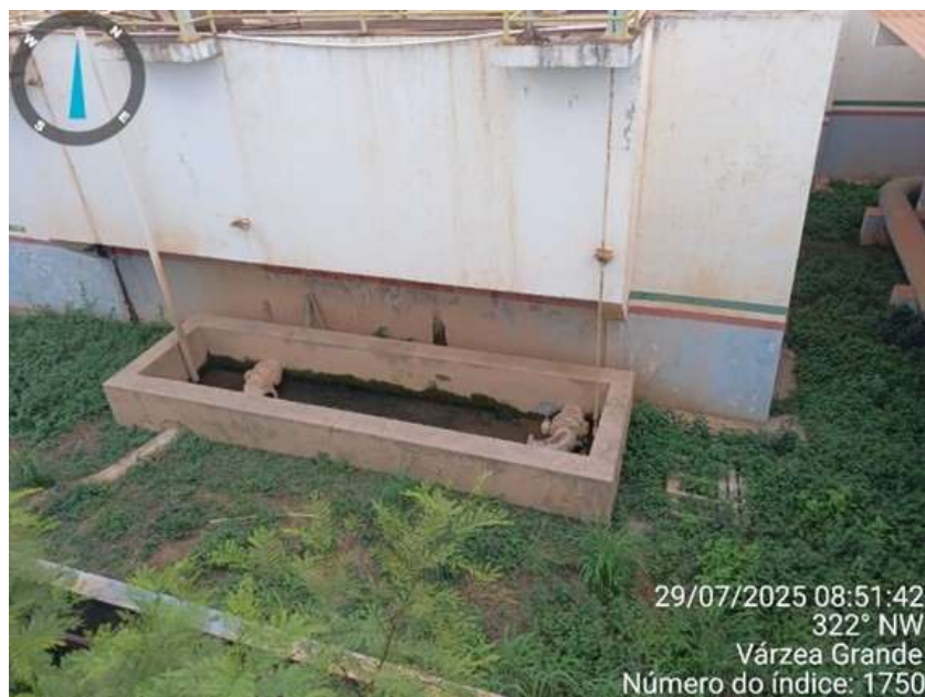
Figura 112: ETA 1 – Caixa de Descarga
