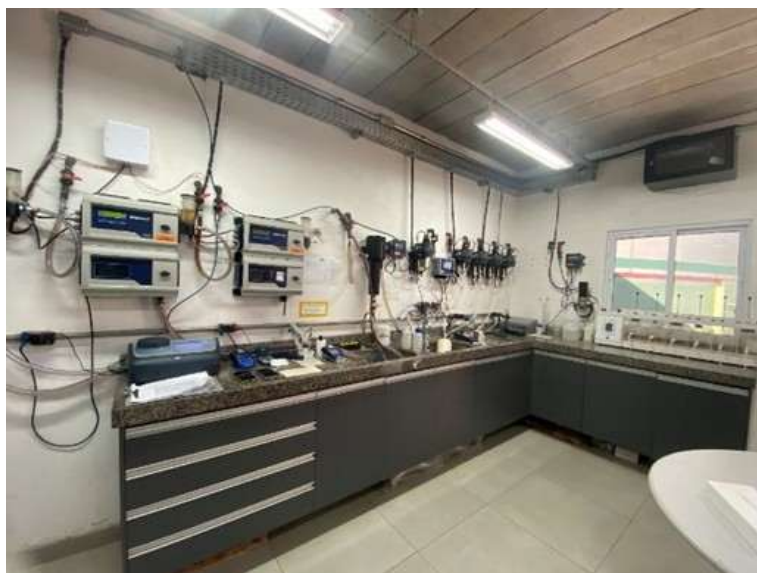
Figura 141: Equipamentos Online e Bancada de Controle de Qualidade de Água Tratada
