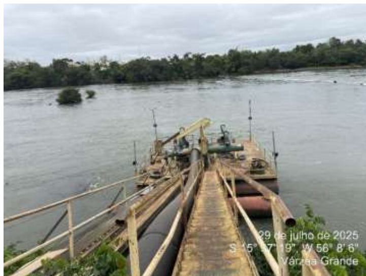
Figura 44: Escada de Acesso Flutuante e EEAB
