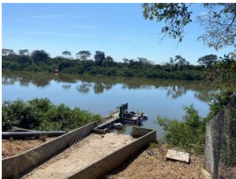
Figura 59: Acesso à Captação de Água Bruta dos Imigrantes
