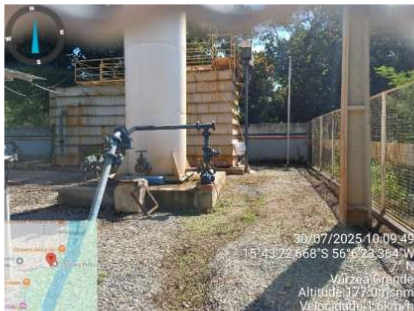
Figura 165: EEAT – para a Rede de Distribuição
