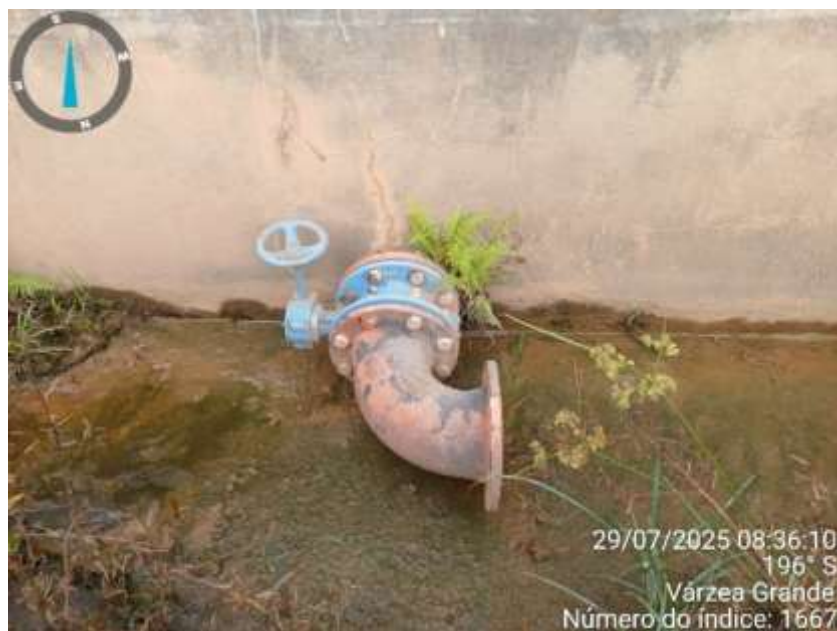
Figura 113: ETA 1 – Registro de Descarga 1
