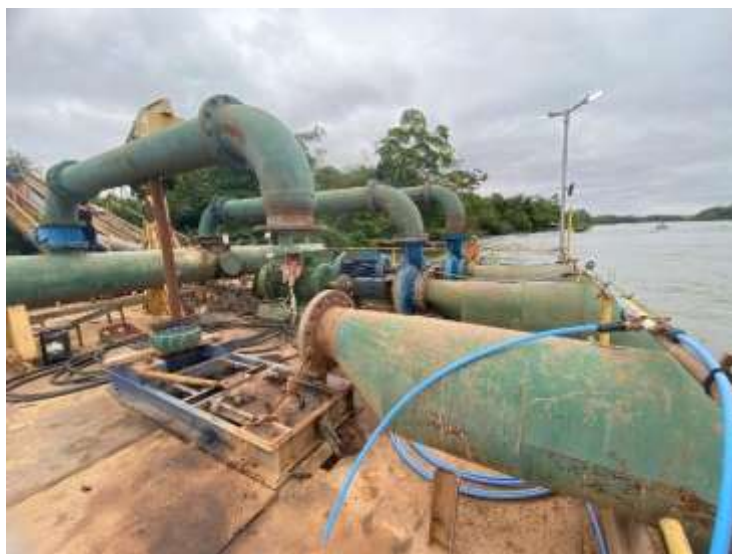
Figura 45: EEAB (02 Conjuntos de Motobombas Instalados e 01 em Manutenção)
