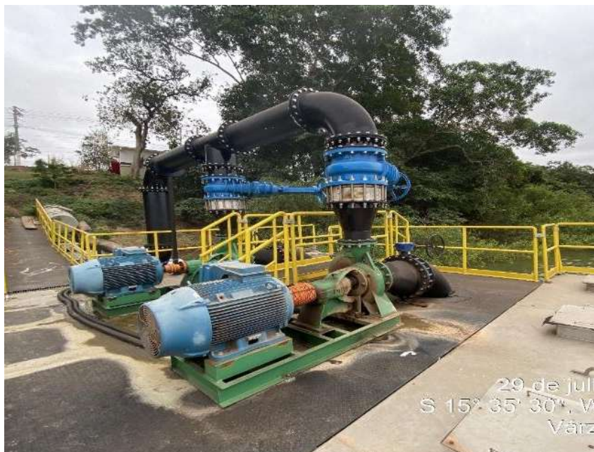
Figura 54: Estação Elevatória de Água Bruta – Captação Barra do Pari
