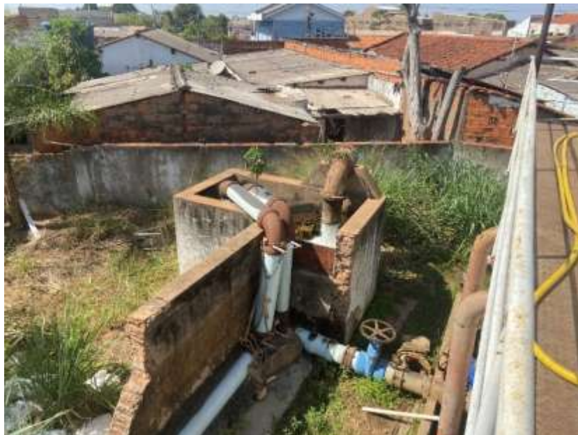
Figura 81: Caixa Receptora de Água Filtrada
