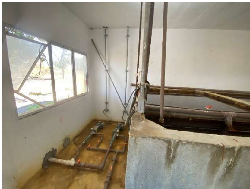
Figura 178: Tanques e Bombas de Recalque de Solução
