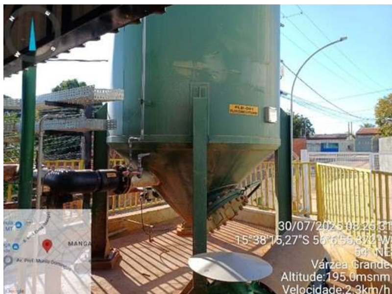
Figura 135: Sistema de Reuso Inoperante
