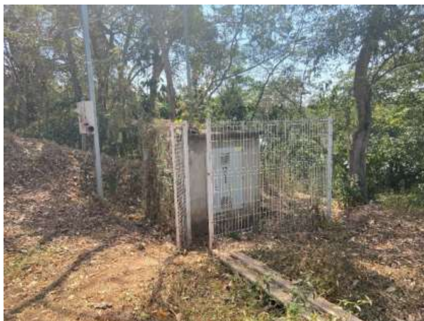
Figura 51: Entrada de Energia e Quadro de Comando
