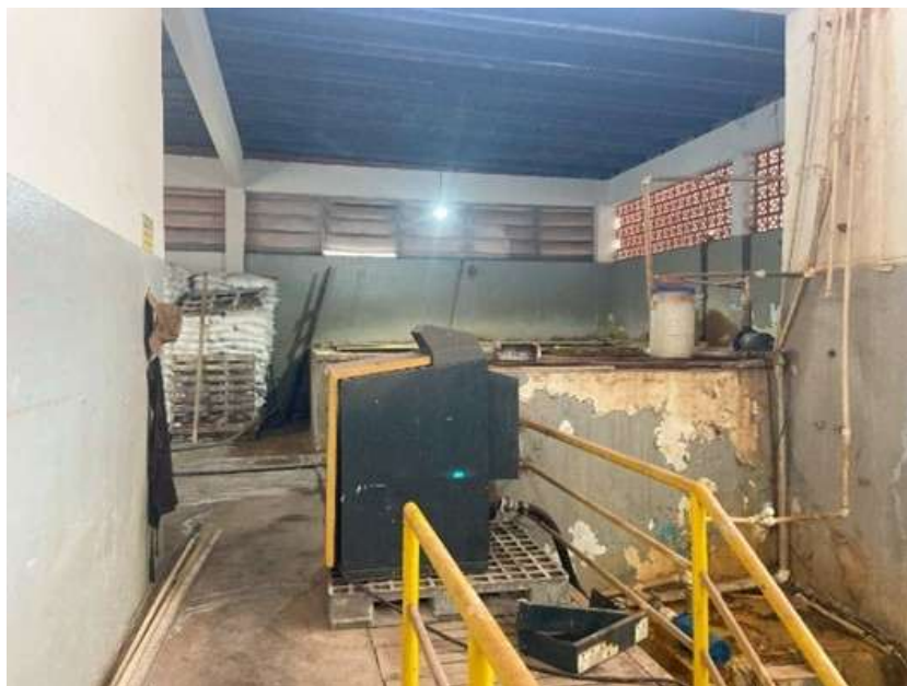
Figura 97: Casa de Química – Tanque de Preparo de Soluções
