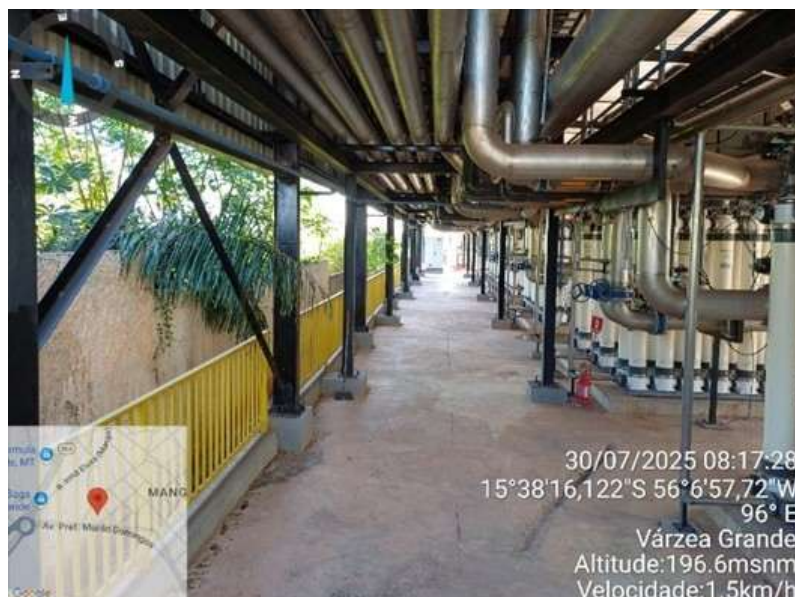
Figura 133: Pipe Rack das Tubulações da ETA Cristo Rei
