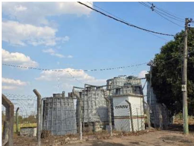
Figura 221: ETE Milton Figueiredo – Reator em Fibra (UASB)
