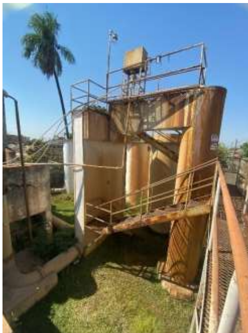
Figura 67: Calha Parshall – Entrada e Distribuição de Água Bruta
