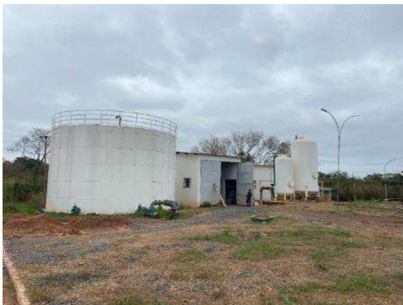
Figura 150: ETA Ginco/BRDU – Vista da Estação de Tratamento, Casa de Química e Reservatório
