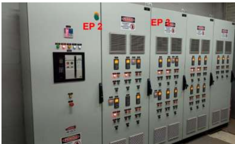
Figura 145: Painéis do Centro de Controle dos Motores em Operação da ETA - Vista Parcial
