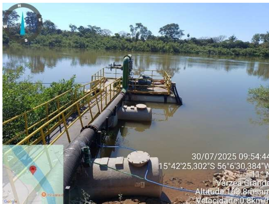
Figura 60: Flutuante com EEAB
