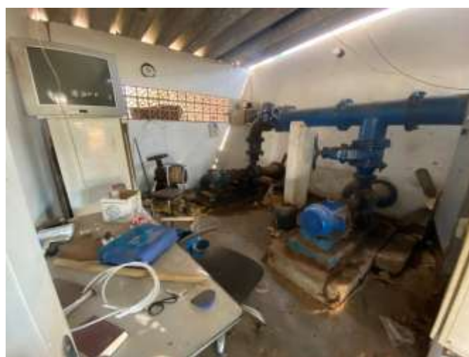
Figura 194: EEAT – Casa de Bombas
