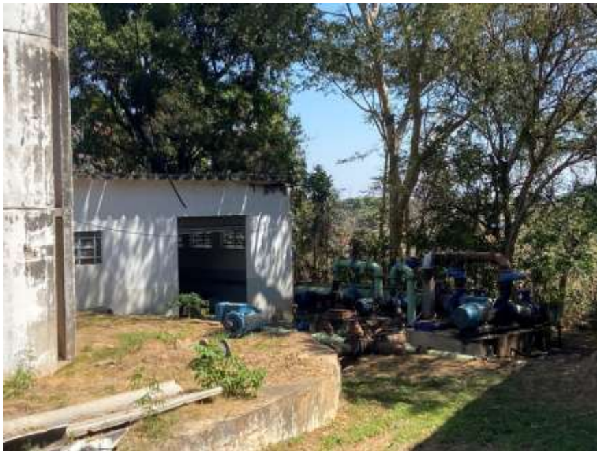
Figura 186: Pressurizadora – Morro do Urubu
