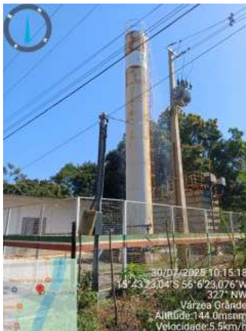
Figura 196: Reservatório de Bom Sucesso
