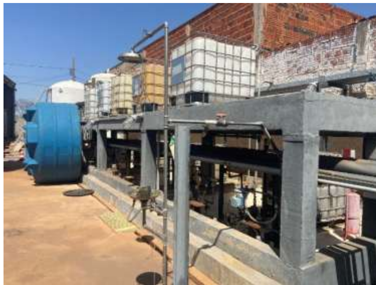
Figura 125: Produtos Químicos (Hipoclorito de Sódio – 12%, Cloreto Férrico, Ácido Cítrico, Ácido Fluossilícico e Soda Cáustica – 50%) e Bombas Dosadoras
