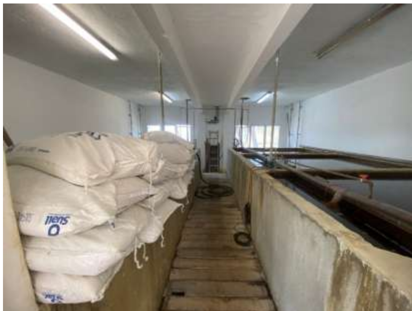
Figura 177: Estocagem e Tanques de Solução
