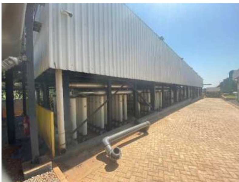
Figura 128: Galpão com os Módulos de Ultrafiltração
