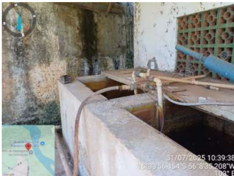
Figura 182: Tanques de Solução
