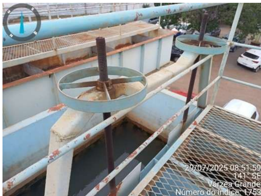
Figura 109: ETA 1 – Válvulas de Controle e Guarda-Corpo
