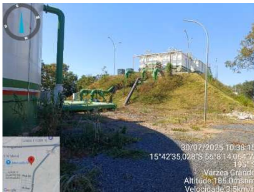
Figura 174: Vista da Saída de Água Tratada
