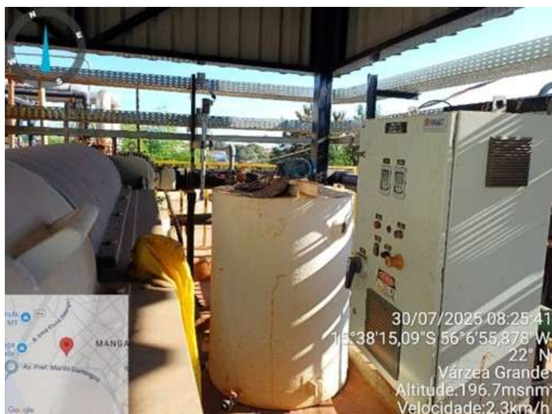
Figura 136: Tanque para o Preparo de Polímero e Desaguamento do Lodo (Inoperante)
