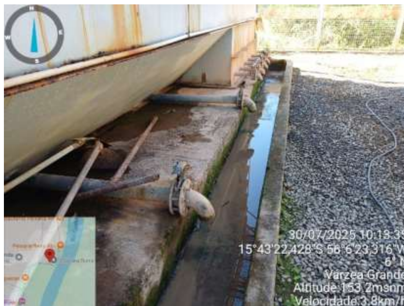
Figura 157: ETA de Bom Sucesso – Caixa de Descarga
