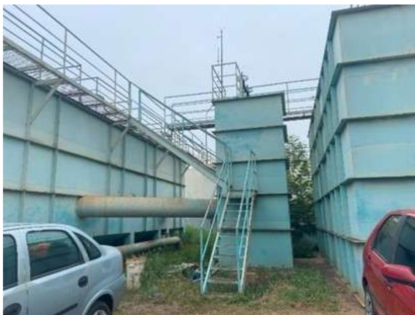
Figura 119: ETA 2 – ETA Metálica – Câmara Intermediária
