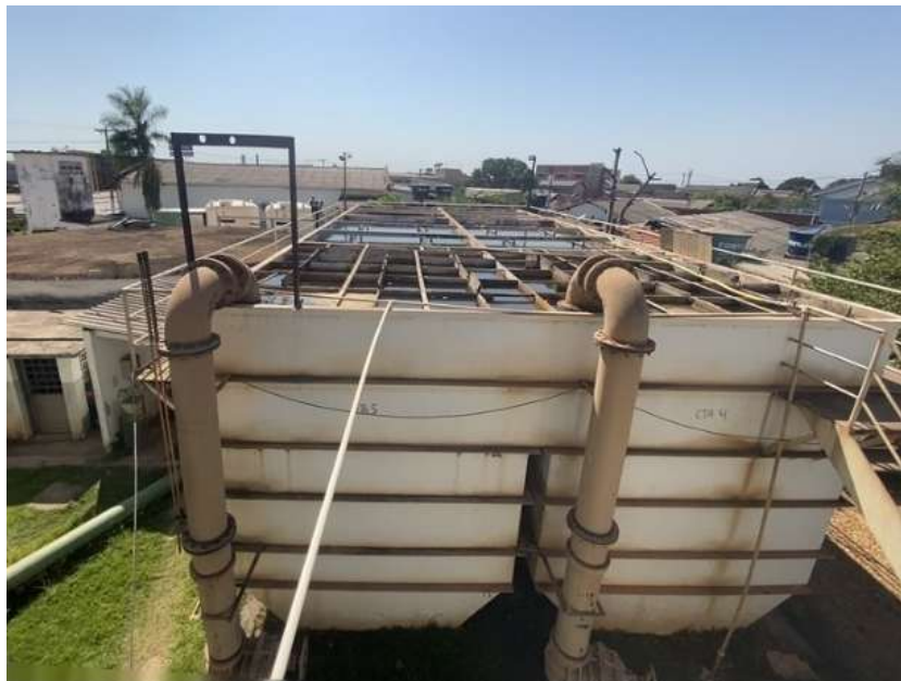
Figura 79: ETAs 4 e 5 – Entrada de Água Bruta
