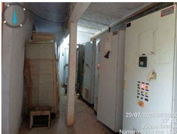
Figura 102: Quadros de Comandos Elétricos
