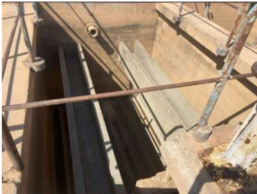
Figura 73: ETA 1 – Filtro Desativado
