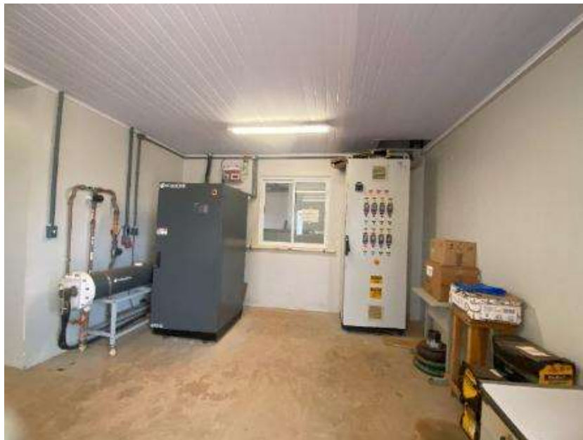
Figura 153: Equipamentos de Comando e Controle Elétricos (02 Imagens)
