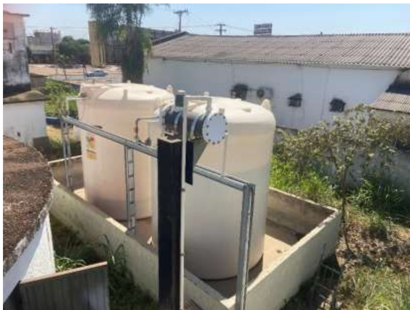
Figura 82: Tanques de Solução para a Desinfecção
