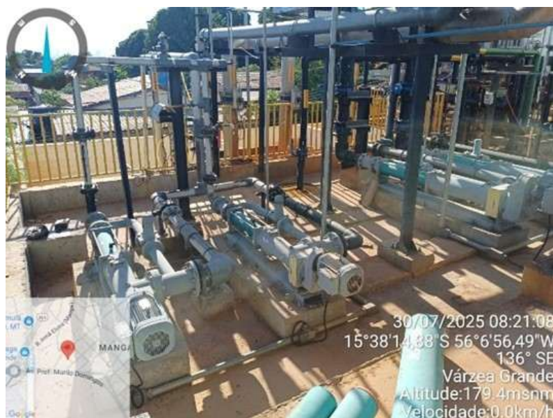
Figura 132: Tanques e Bomba Helicoidais do Sistema de Neutralização e Reaproveitamento da Água de Lavagem dos Módulos de Ultrafiltração
