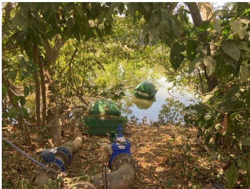
Figura 48: Unidades Flutuantes da Captação Ginco/BRDU
