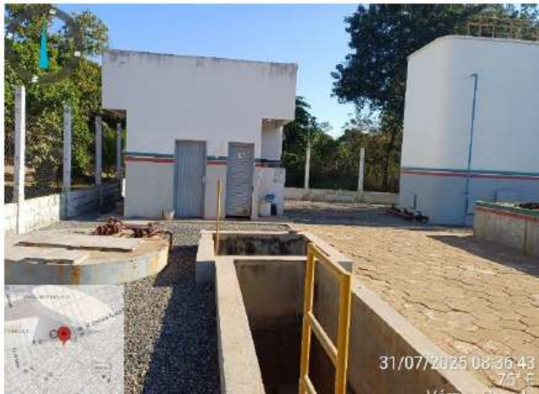
Figura 223: ETE Vila São João
