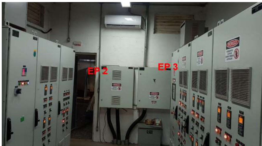
Figura 143: Painéis do Centro de Controle dos Motores em Operação da ETA
