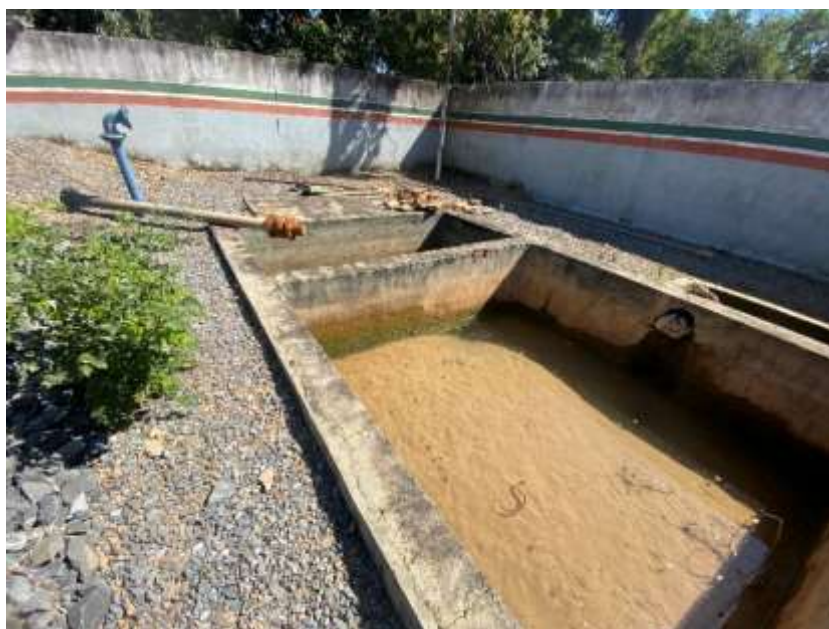
Figura 161: Tratamento do Lodo – Leito de Secagem
