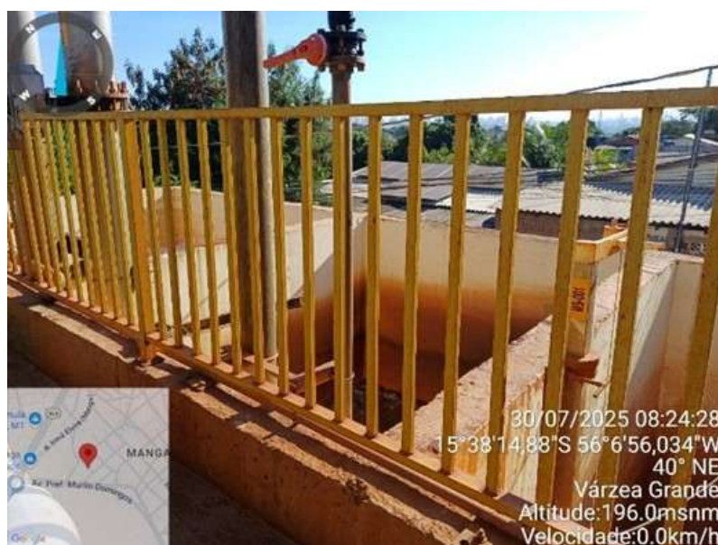
Figura 140: Tanque de Água de Lavagem dos Módulos de Ultrafiltração
