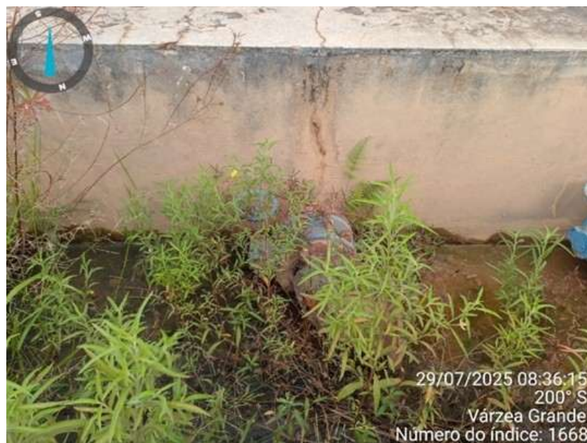
Figura 115: ETA 1 – Registro de Descarga 2
