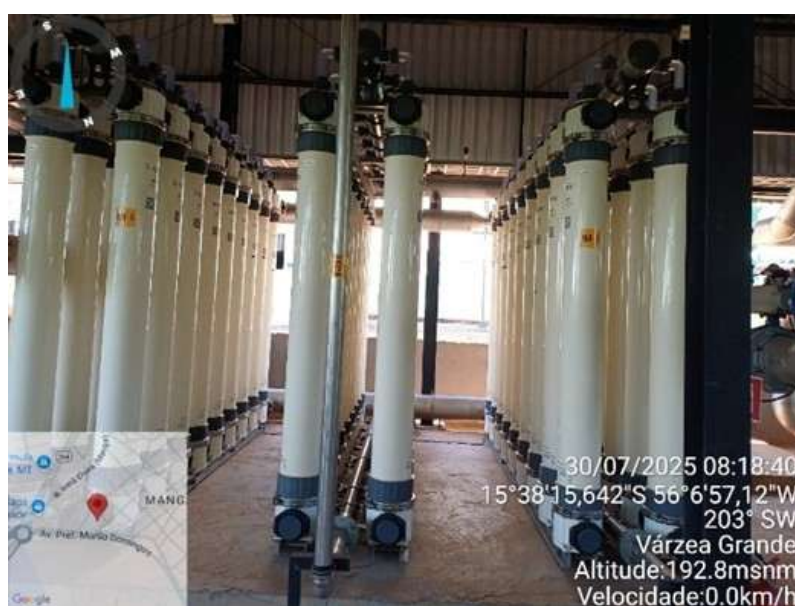
Figura 134: Módulos de Ultrafiltração em Operação
