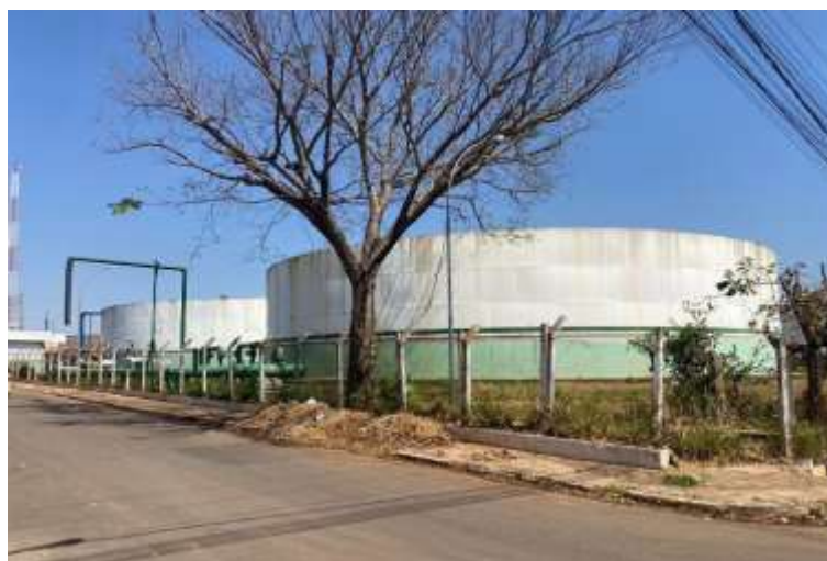
Figura 192: Reservatórios 1 e 2 – ETA Cristo Rei
