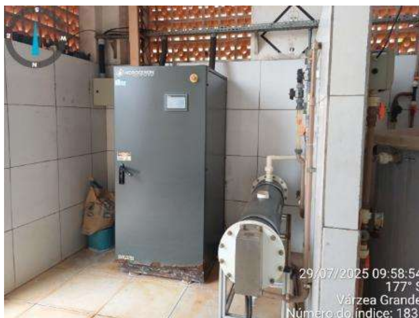
Figura 84: Piso Térreo da Casa de Química – Quadro de Energia
