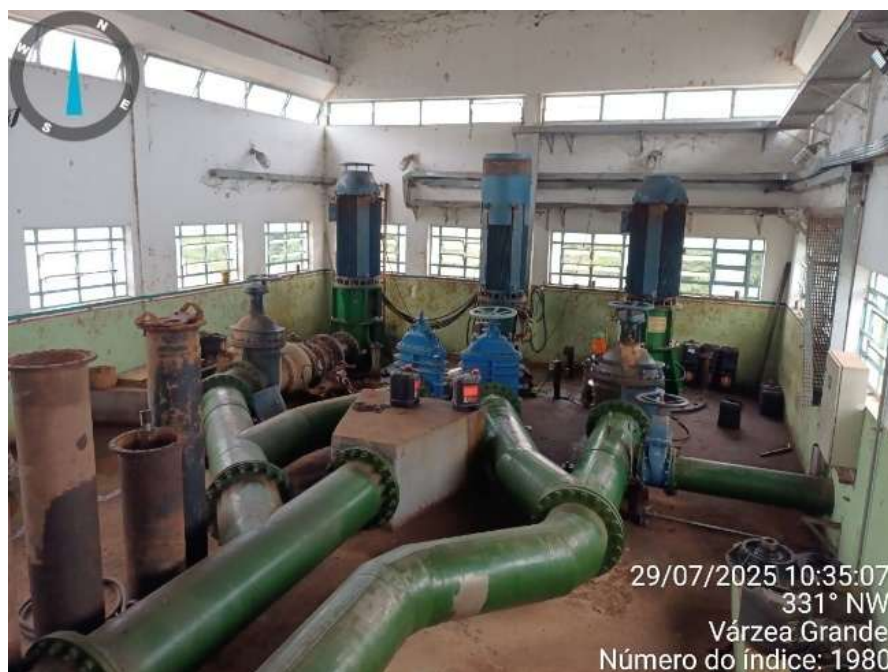
Figura 42: Estação Elevatória de Água Bruta
