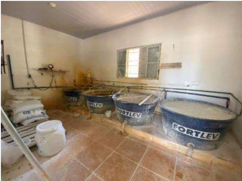
Figura 162: Tanques de Solução de Produtos Químicos
