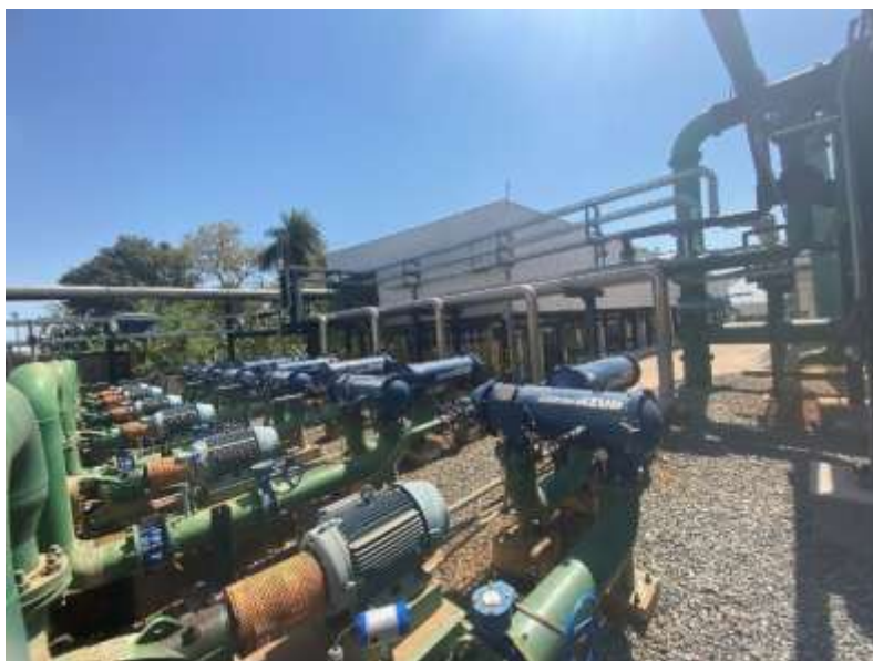
Figura 129: Conjuntos de Motobombas e Filtros de Tela para a Alimentação dos Módulos de Ultrafiltração – Vista Parcial
