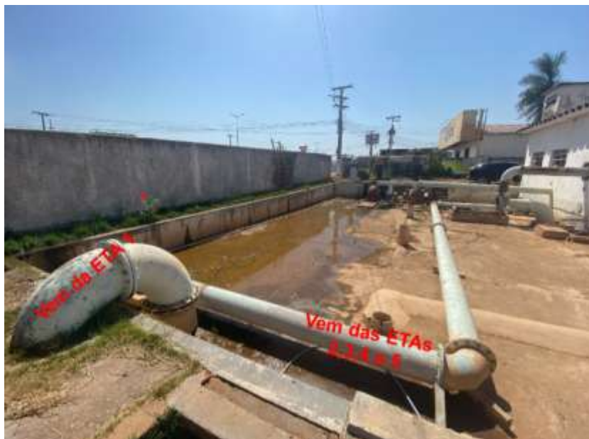
Figura 83: Entrada de Água Filtrada no Reservatório Enterrado
